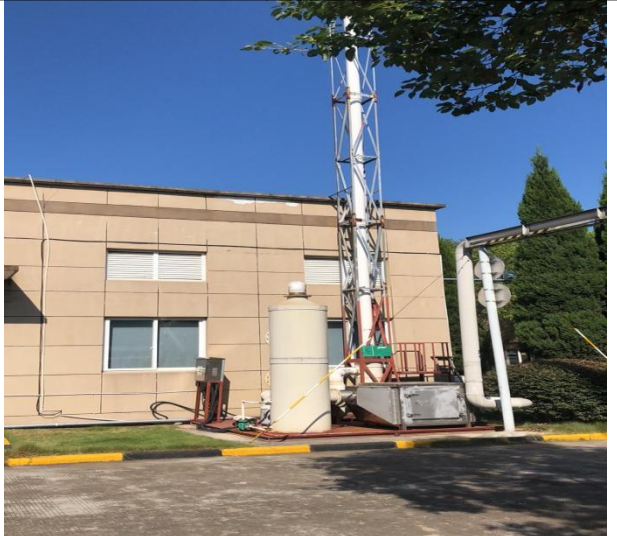
污水站废气处理设施
